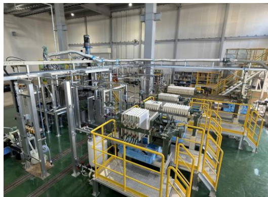
実証プラント全体
