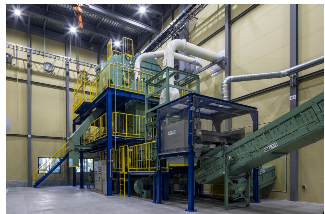
第3工場に設置した縦型破砕機
