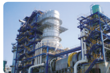
焼却処理プラント
