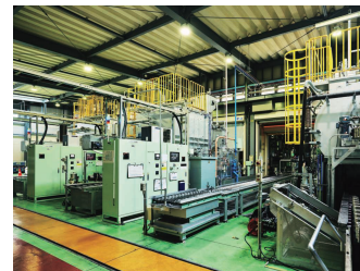
CO 2 排出を減らした次世代熱処理炉
