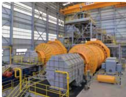
鉱石粉碎設備
