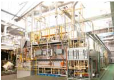
セム(株)の熱処理設備
