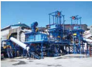
エコシステム花岡樹の土壌浄化設備
