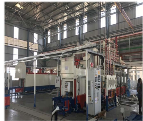
インド新工場の熱処理設備
