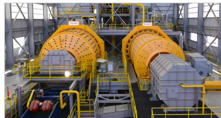
鉱石粉碎設備
