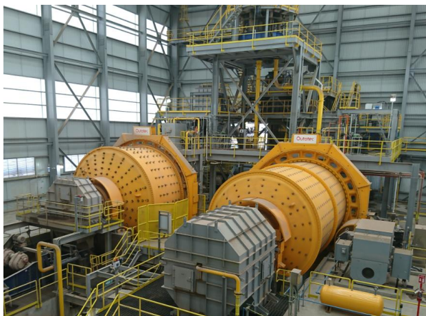
ロス・ガトス鉱山の鉱石粉砕設備
