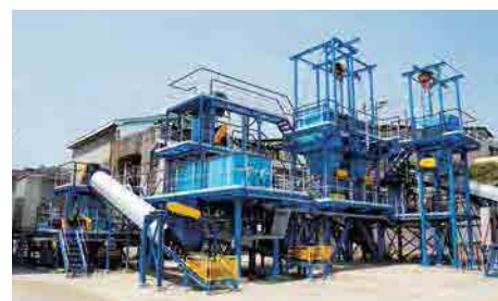
独自の浄化工法を採用したエコシステム花岡(株)の土壌浄化施設
