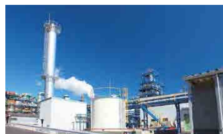
エコシステム秋田(株)の低濃度PCB廃棄物処理施設
