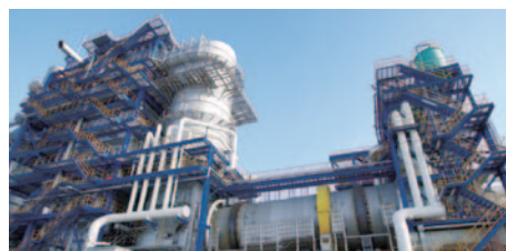
エコシステム千葉(株)の廃棄物焼却炉
