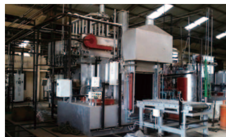
インド拠点で製作した工業炉
