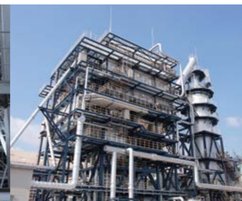
自動車リサイクルの処理設備
