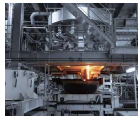
廃棄物の溶融・再資源化設備
