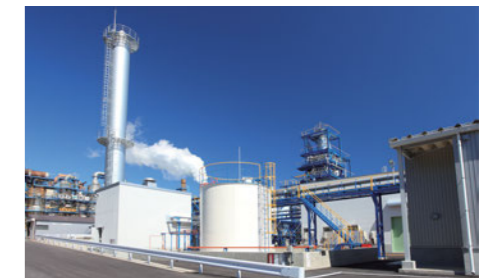
エコシステム秋田の低濃度PCB廃棄物処理施設
