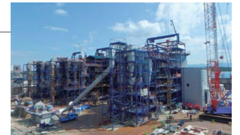
新設・更新を進める秋田製錬の焙焼炉
